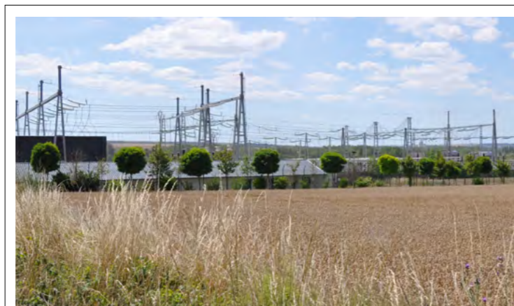
• Poste de transformation EDF, La Chaussée-sur-Marne (CCMC) © AUDC
